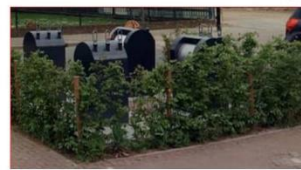
Groen omkleding containers en schakelkast, diverse hoogtes.
